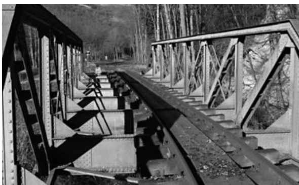
Bei der Stahlfachbrücke in km 3,154 am Haltepunkt Schweppenbrunn-Heilbrunn wurde der fehlende durchgehend begehbare seitliche Randweg bemängelt, Aufnahme am 9.2.08
