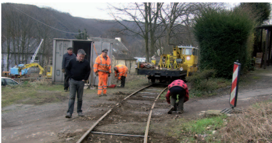
Bevor der Gleisabschnitt am Dickberg Ende 2009 mit Fördermitteln grundsaniert werden konnte, drohte ein halbes Jahr davor zu Saisonbeginn wegen des schlechten Gleiszustandes der Ausfall des Bahnbetriebes für Personen und Güter für längere Zeit. In einer Gewaltaktion gelang es den Aktiven des Vulkan-Expreß kurz vor dem Saisonbeginn die vorläufige Reparatur. Foto: Hans-Josef Merzbach
